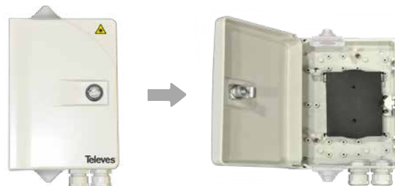
Repartidor Geral de Fibra Ótica RG-F0 16
